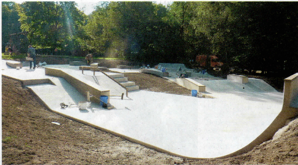
Bis zuletzt wurde an dem Skate-Park gewerkelt. Heute um 14 Uhr wird er offiziell eingeweiht. Foto: Pierre-Claude Hohnh
